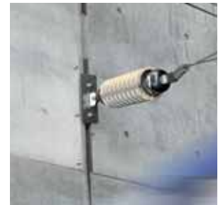
Befestigung von Oberleitungen in Tunneln und auf Bahnstrecken
