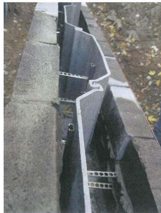
Im PFA 8 wurden die Schienen direkt an den Spundbohlen, zur dauerhaften Befestigung des Basalmauerwerks, befestigt. Fotos: Deutsche Kahneisen Gesellschaft mbH, Berlin
