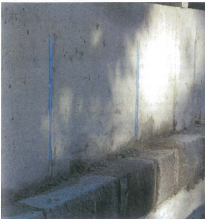
Die Maueranschlussschienen wurden im Abschnitt „Weißer Bogen“ direkt in die Betonwand einbetoniert. Die blaue Schaumfüllung verhindert das Eindringen von Beton.
