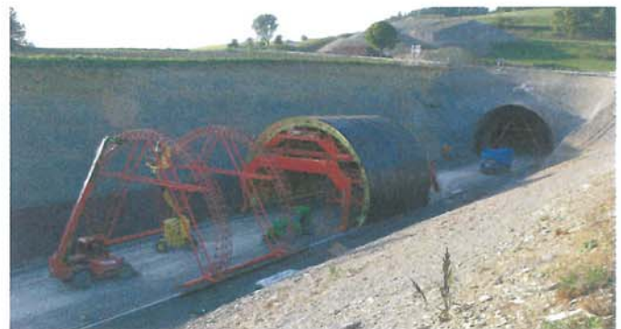
Bild 2. Der als zweischaliges Bauwerk entstehende Bleßbergtunnel wurde mit JORDAHL® Ankerschienen JTA W53/34 in Edelstahl ausgestattet – ein spezieller Schalwagen dient dem Einbau der inneren Tunnelschale (Bilder 1, 2: DB AG)
