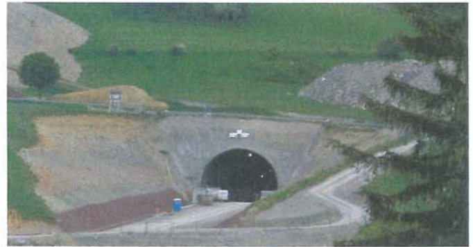
Bild 1. Die Tunnel der NBS Ebersfeld–Erfurt–Leipzig/Halle (Saale) (hier der Bleßberg-tunnel) können mit bis zu 300 km/h befahren werden; die dabei auftretenden hohen dynamischen Lasten an den Fahrdrähten werden über Ankerschienen sicher in das Bauwerk abgeleitet
