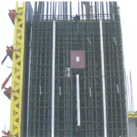
Bild 2. Zur sicheren Befestigung der Anlagenkomponenten und Medienleitungen entschieden sich die Planer auch für Ankerschienen – insgesamt werden über 7 km dieser Schienen im Block 9 verbaut; sie werden direkt in den Bewehrungskorb eingebunden und dann oberflächenbündig einbetoniert
