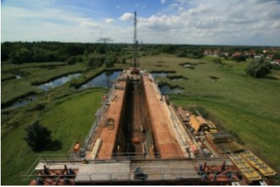
„Vor-Kopf-Bauweise“ - eine ingenieurtechnische Herausforderung. Die Auenlandschaft darf beim Bau der Saale-Elster-Talbrücke nicht betreten oder befahren werden. Foto: Frank Eritt
