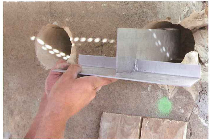
Bild 1. JORDAHL® Einmörtelkonsolen waren beim über hundert Jahre alten Mauerwerk das Mittel der Wahl zur Abfangung der Ziegel-Verblenderschale
