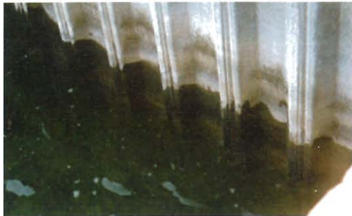
Bild 3. Selbst im Bereich der Wasserwechselzone befinden sich die Spundwände in einem guten, funktionsfähigen Zustand, auch wenn erste Anzeichen von Korrosionsprodukten zu sehen sind (Fotos: Institut Feuerverzinken)
