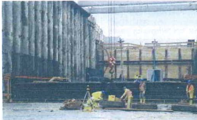
2 Der in offener Bauweise und in Deckelbauweise gefertigte Denkendorf-tunnel wurde mit Ankerschienen JTA W53/34 in Edelstahl ausgestattet (DB AG/Weber)
